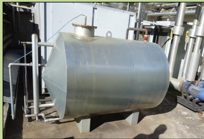
Figura 5. Tanque de condensado.
